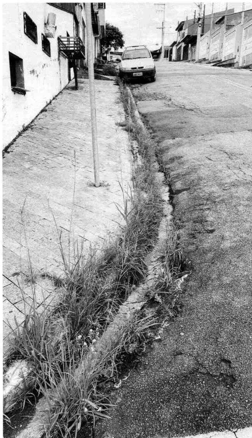
CAPINAÇÃO DE CABEÇAS DE GUIAS E RASPAGEM DE SARJETAS EM TODA A EXTENSÃO DA RUA AUGUSTO MOREIRA DOS SANTOS, VILA CINTRA – MOGI DAS CRUZES.
